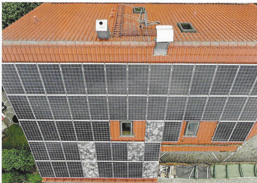
Hoffentlich versichert: Solargenerator mit fünf zerstörten Modulen nach einem Hagelsturm, der Pfingsten 2019 den Südwesten Bayerns heimsuchte
